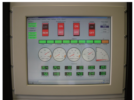
图 2 移动雷达系统控制机柜触摸屏 Fig. 2 The touching screen in Shanghai DWSR-2001X-SDP/M radar system
